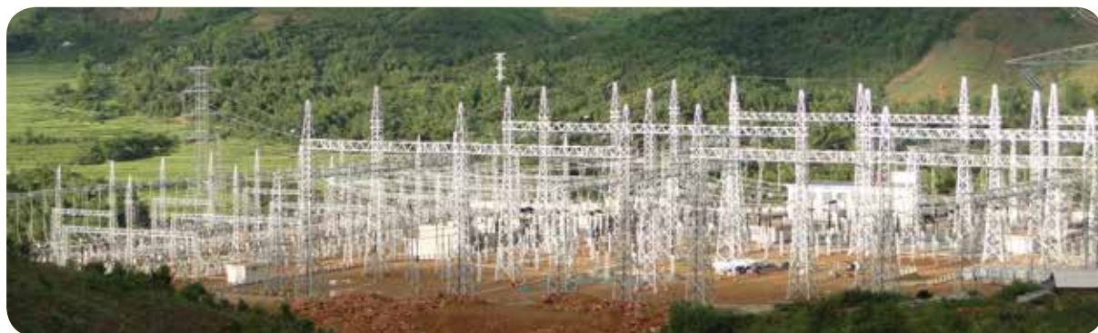
Trạm biến áp 500kW Sơn La
